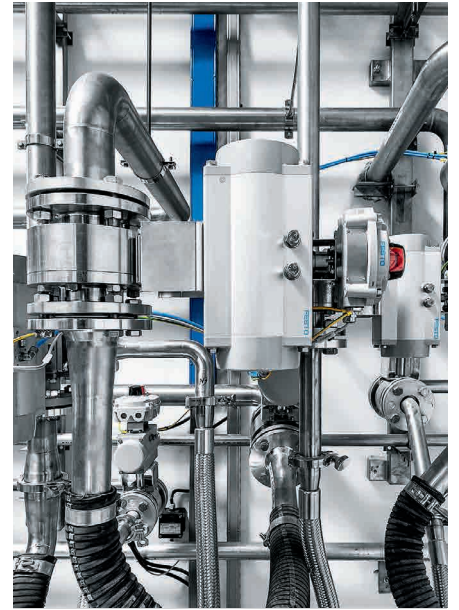
Saubere Lösung: eine der Prozessventil- einheiten.
