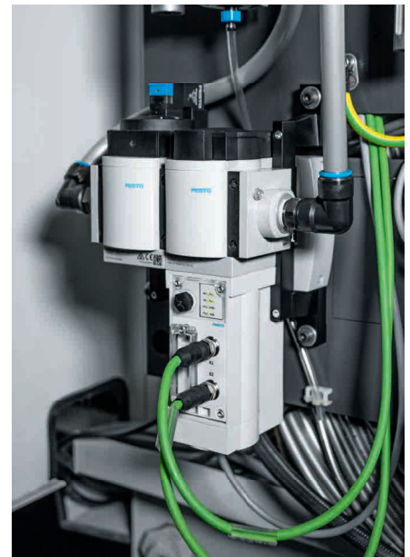
Vorab definierte Druckabfallparameter ermöglichen das selbstständige Erkennen von Leckagen im Leitungssystem.
