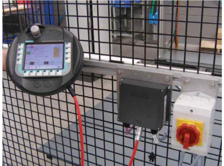
Mobiler Touchscreen mit Anschlussbox und abgesetztem Hauptschalter
