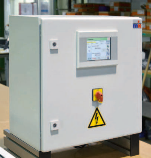
Schaltschrank mit Bedienpanel an dem kleine Programmänderungen direkt vorgenommen werden können
